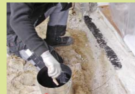
8. Der Beton wird mit einem Primer vorbereitet, um später einen sauberen und dichten Folienanschluss im Fußbereich sicherzustellen.
